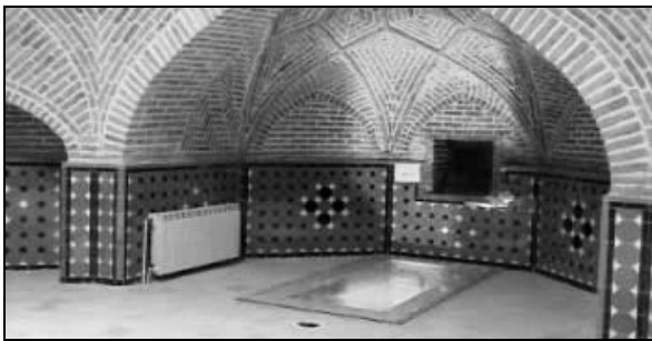
شکل ۱۰. عدم سنخیت شوفاژ با حمام قجر قزوین پس از مرمت
